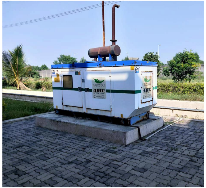
DG Set Area
